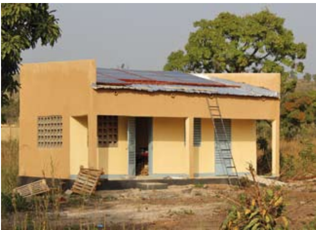
13 panneaux solaires ont été installés sur la maison du gardien.
